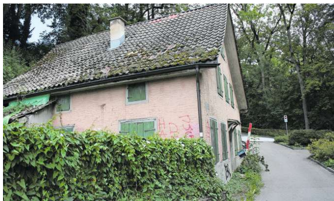
Das Häxähüsli am Stadtweier ist stark baufällig.
